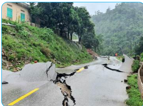
Hình 9.1. Tuyến đường giao thông bị hư hỏng do sạt lở núi ở huyện Minh Hoá
