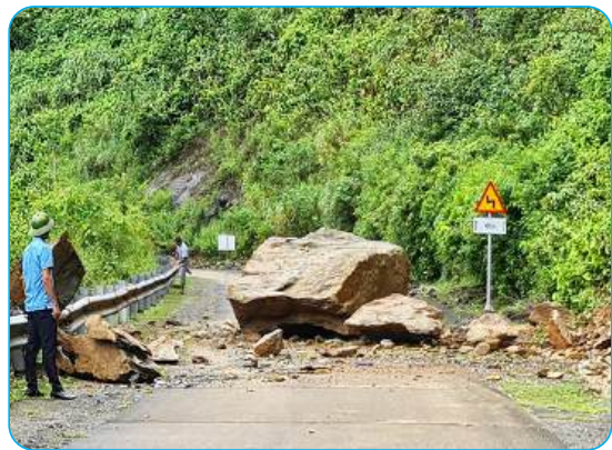
Hình 9.4. Mưa lớn gây sụt lở đường đê ở huyện Quảng Ninh
