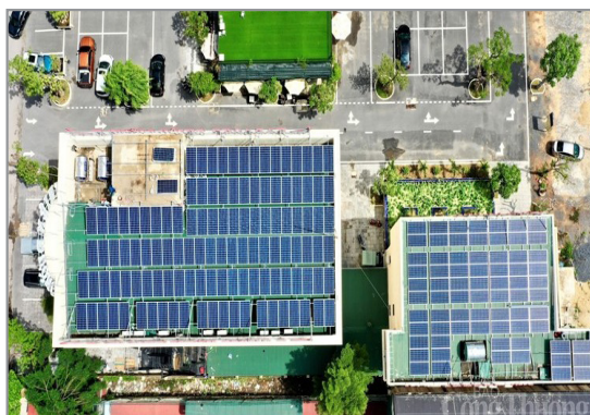
Hình 8. Hệ thống điện mặt trời mái nhà của Công ty TNHH PARADIZE Thiên Đường (thành phố Đồng Hới) nhìn từ trên cao
