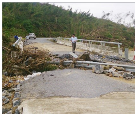
Hình 4. Nhiều tuyến đường giao thông bị sạt lở, hư hỏng do bão lụt
