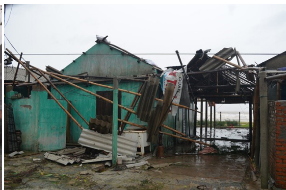
Hình 2. Bão làm tốc mái nhà
