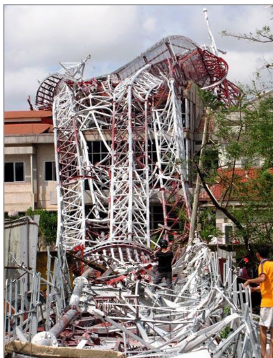
Hình 6. Sập tháp ăngten do bão số 10 năm 2013
